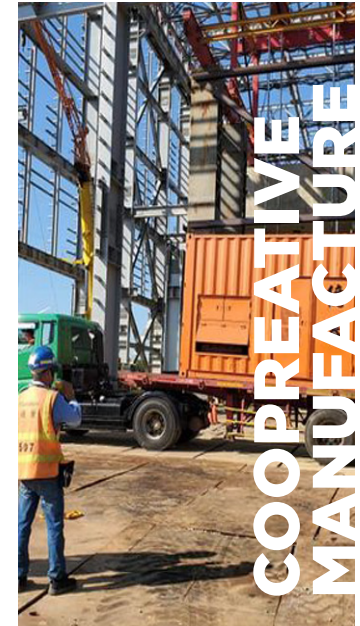
桃園大潭發電廠 2021大潭發電廠750KW發電機塔吊供電
